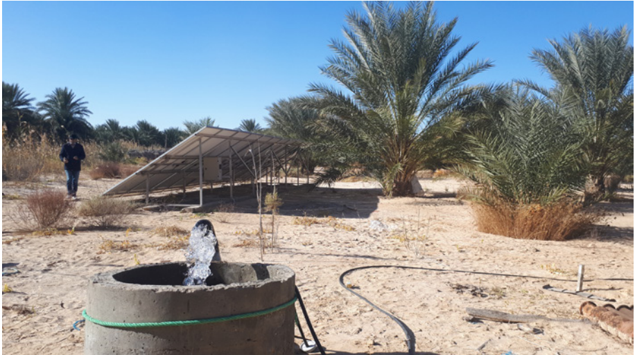
Le système d'irrigation par pompage solaire fonctionne au moyen de panneaux photovoltaïques. Grâce à l'énergie générée par ces panneaux, la pompe s'active et puise l'eau disponible dans les nappes phréatiques.
