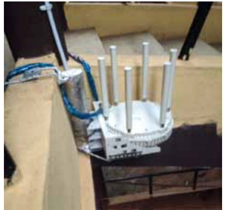
Illustration 11 : Radio sans fil évoluée, infrastructure du dernier kilomètre pour connectivité aux terminaux de paiement
